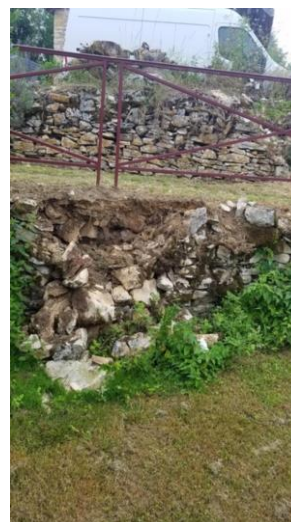
Le mur de soutènement du passage Maurice Menut commence à se dégrader avec un premier écroulement. L'intervention d'une entreprise de maçonnerie a été programmée. La reconstruction interviendra en plusieurs phases (sur 2/3 ans).
